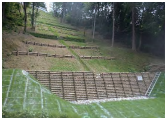
木製土留工(喬木村寺の前)
