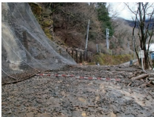
市道の被災状況(R6.4)
